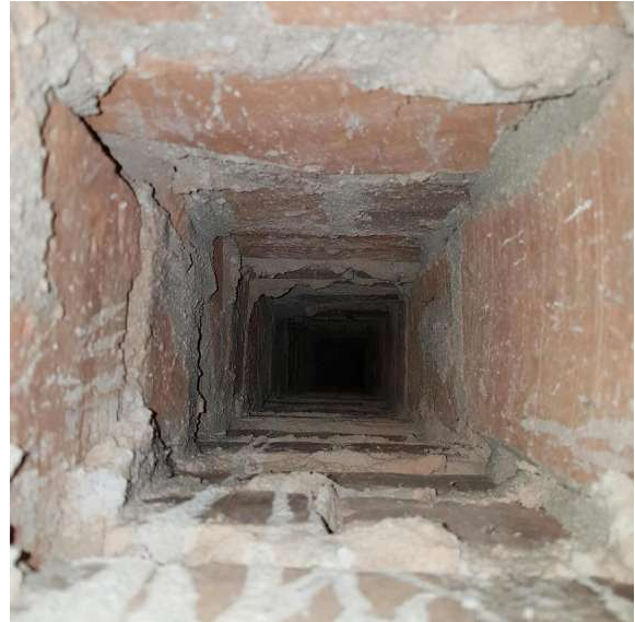
Tegelkanal före tätning
