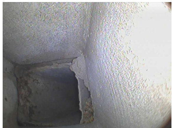
Eternitkanal före tätning
